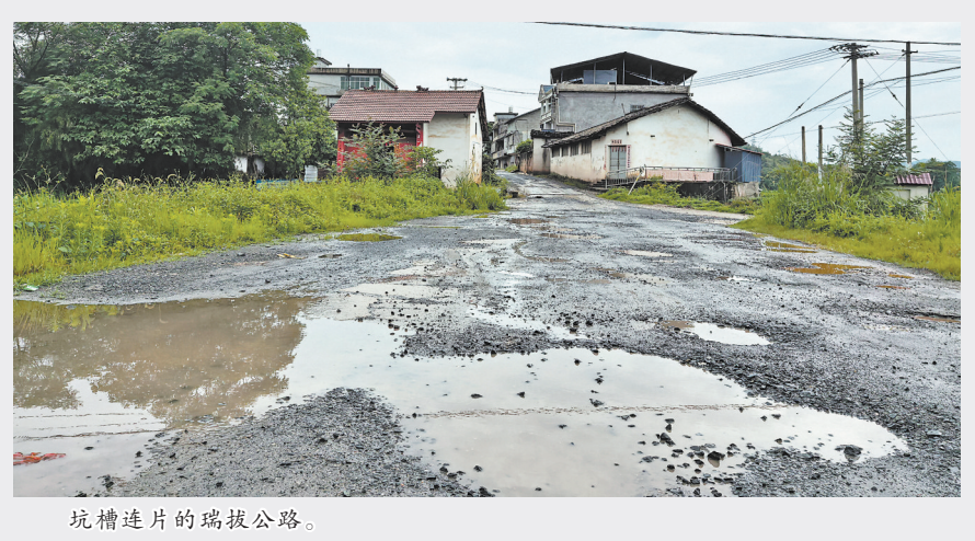
坑槽连片的瑞拔公路。
