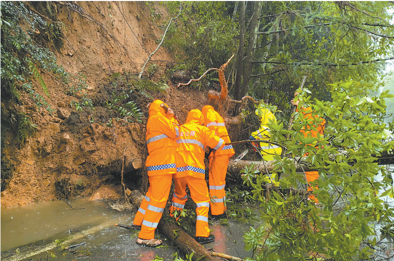
井冈山S540多处路段接连发生边坡塌方、落石等险情，当地公路分中心迅速组织养护人员赶赴一线开展巡查和抢通。 通讯员 叶友华摄
