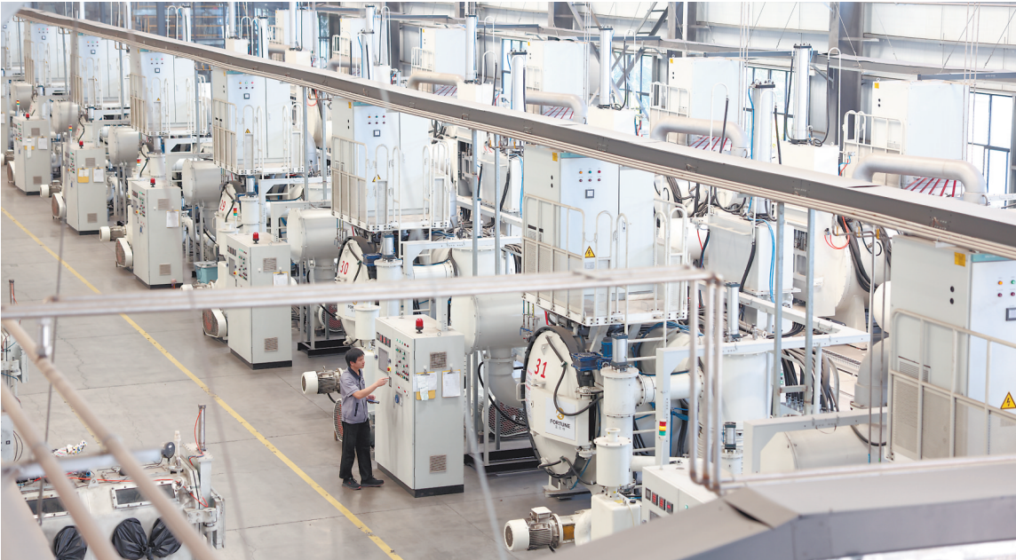
位于赣州经开区的赣州富尔特电子股份有限公司生产车间内,工人在赶制订单。
